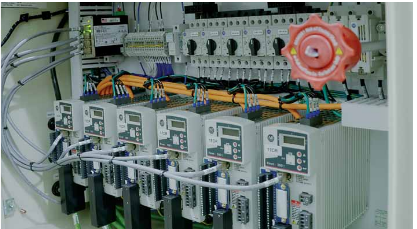
Verdrahtung in und am Schaltschrank: LÜTZE Kabelkonfektionen sind immer kompatibel und bieten viel Flexibilität.
